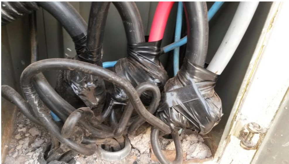
Foto 02 – Detalhe Quadro Geral de Força
