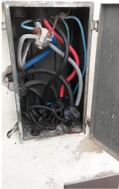
Foto 01 – Quadro geral de força sem nenhum tipo de proteção e barramento.
