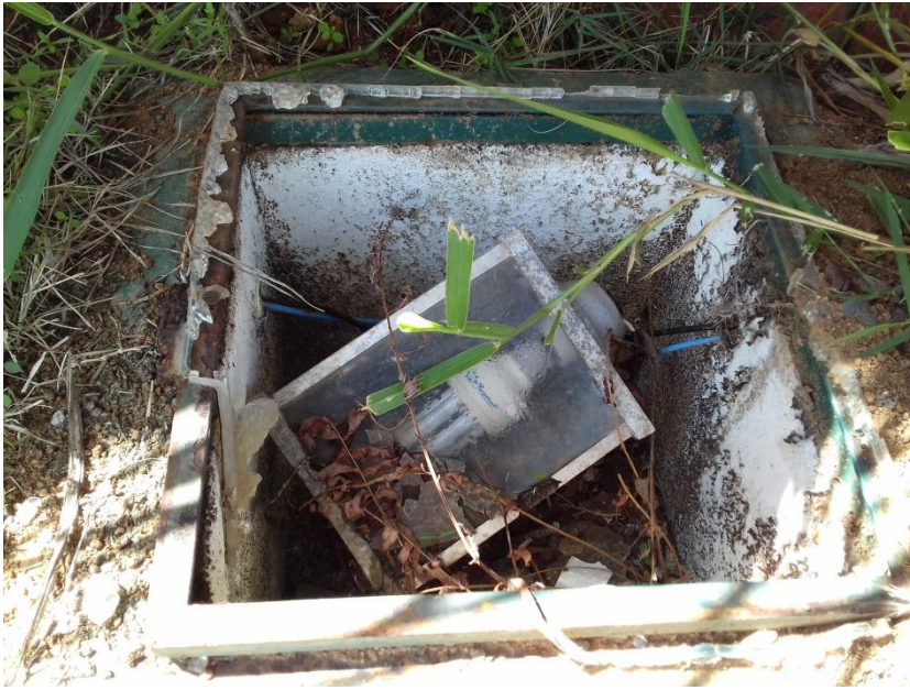
Foto 05 – Ausência de tampa de proteção da fiação e iluminação do jardim
