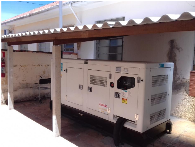
Foto 08 – Gerador da Fundação com melhorias de cobertura
