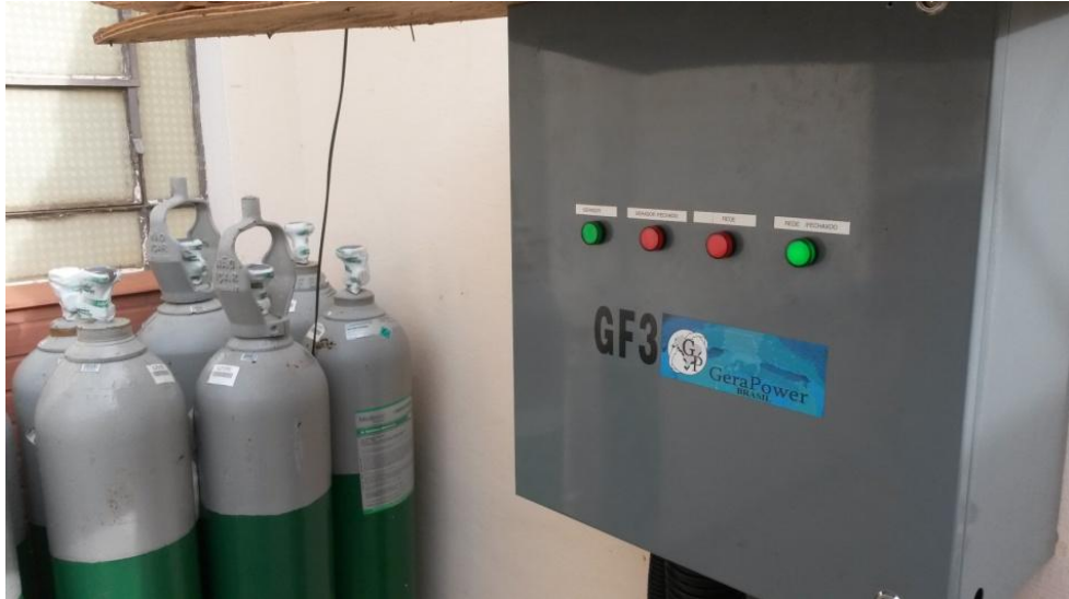
Foto 09 – Cargas estáticas próximas a painel elétrico
