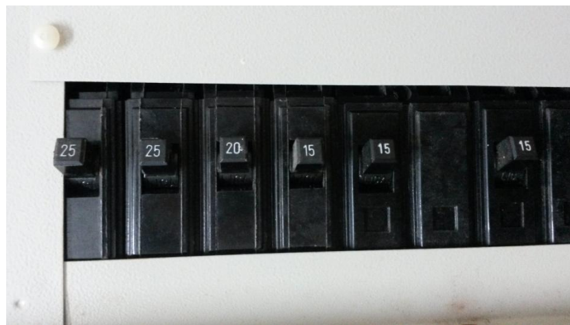
Foto 12 - Detalhe ausência de identificação de circuitos
