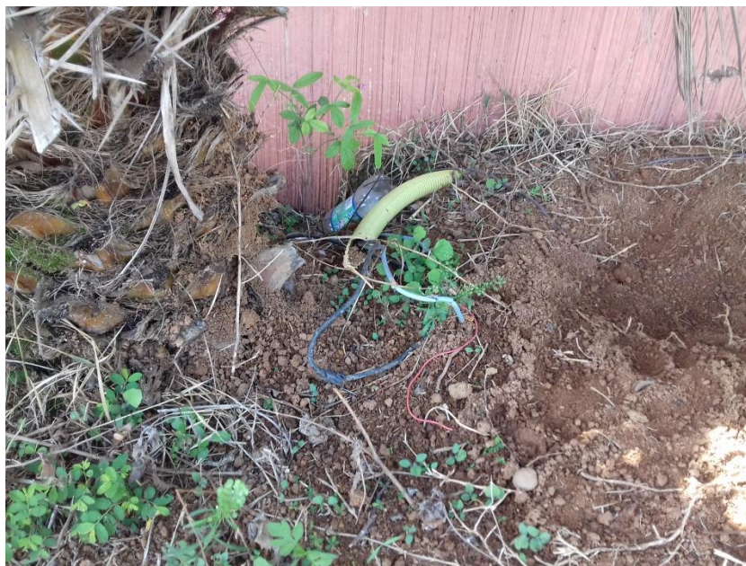
Foto 04 – Fiação do jardim frontal com eletrodutos danificados
