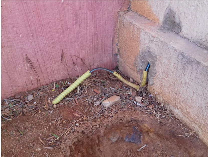
Foto 03 – Fiação do jardim frontal com eletrodutos danificados
