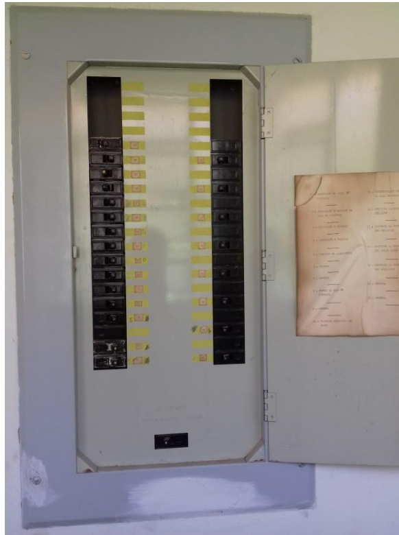
Foto 13 – Identificação de circuitos deteriorada
