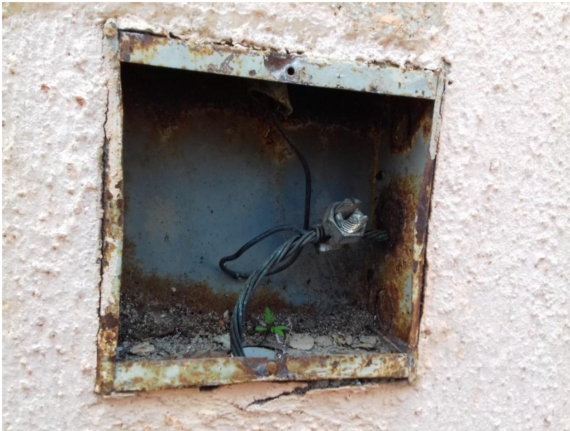
Foto 06 – Fiação aterramento com parafuso desapertado e fiação oxidada
