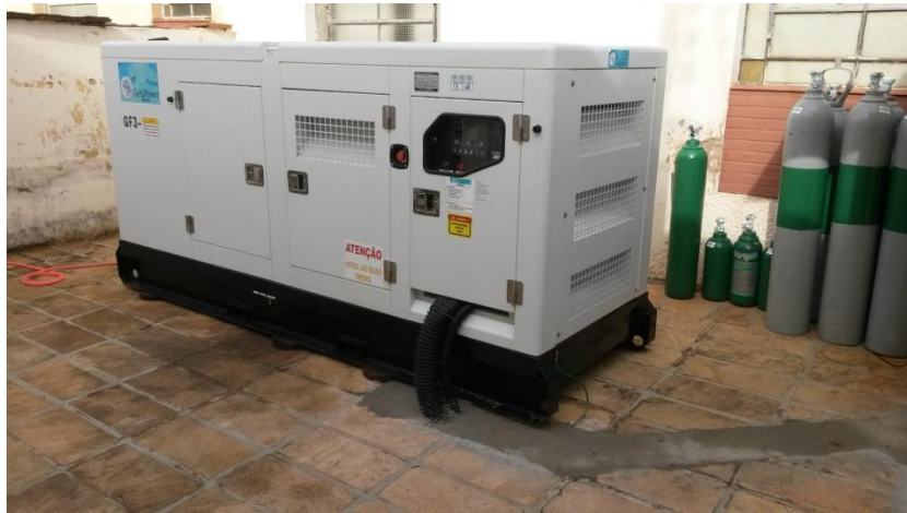
Foto 07 – Gerador da Fundação exposto ao tempo
