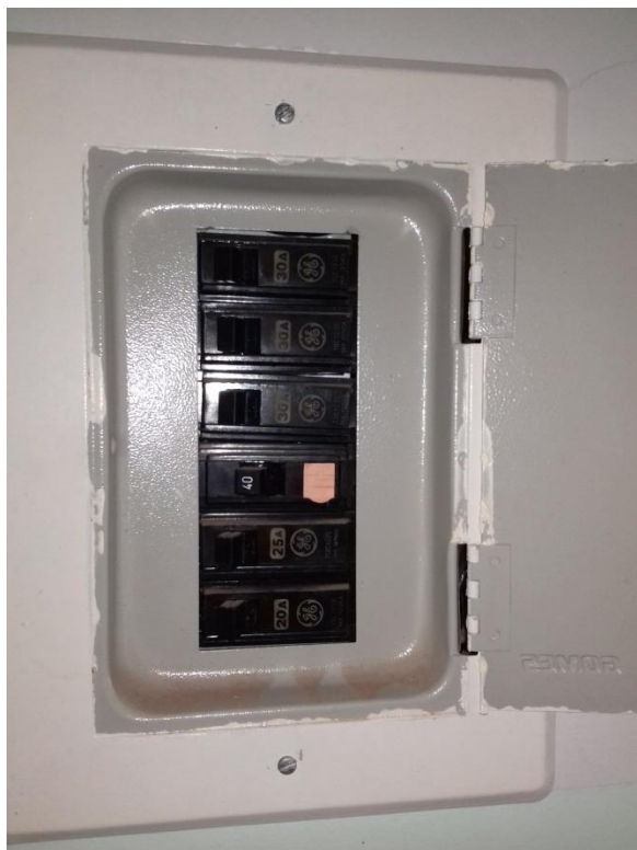
Foto 14 – Disjuntores sem identificação
