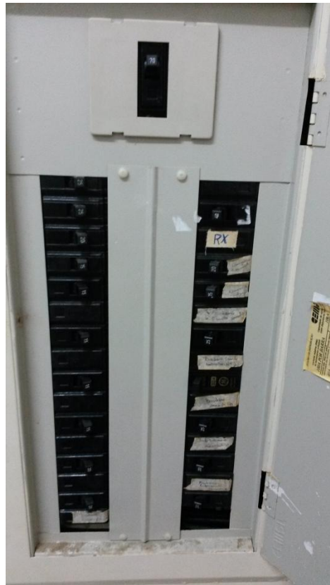
Foto 11 - Ausência de identificação de circuitos
