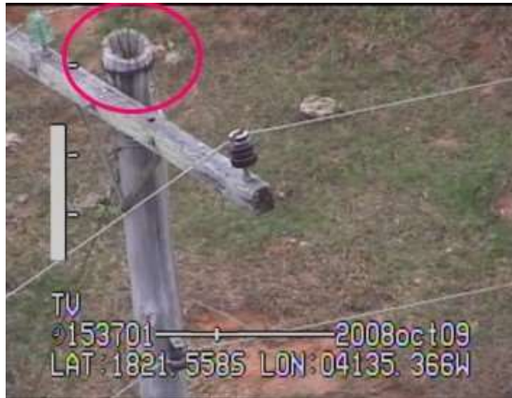
Figura 34: Poste com anomalia no topo
