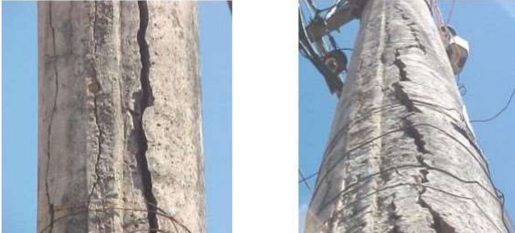
Figura 21: Poste de concreto trincado
