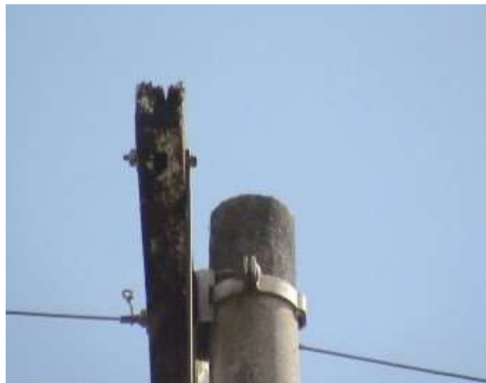
Figura 22: Deterioração da ponta da cruzeta
