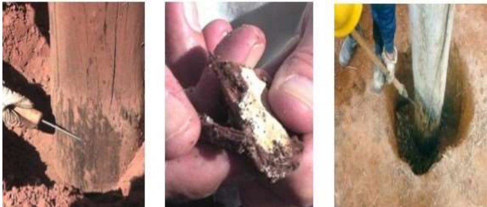
Figura 20: Poste de madeira com fungos
