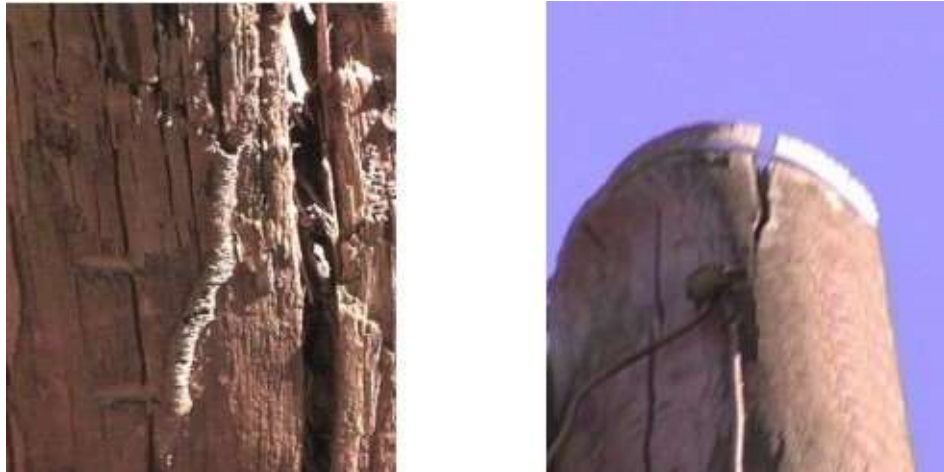
Figura 19: Poste de madeira rachado
