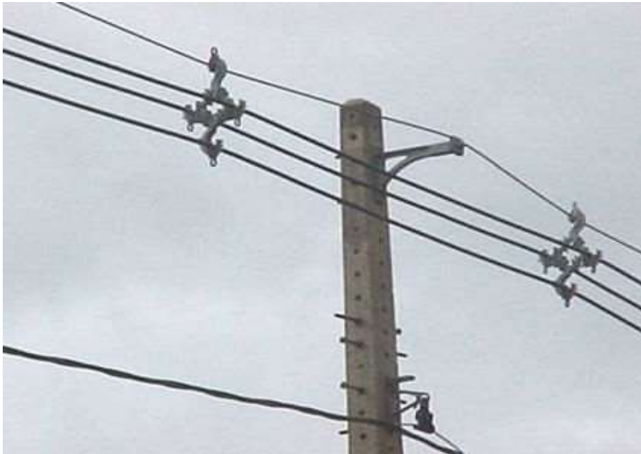
Figura 3: Rede de distribuição aérea compacta
