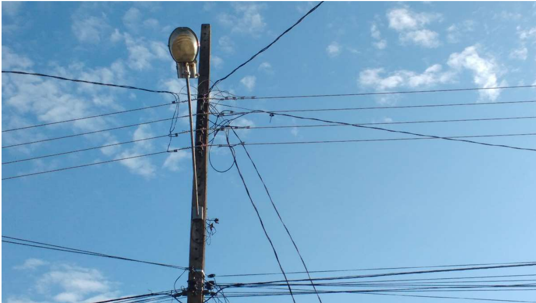
Figura 2: Rede de distribuição aérea convencional
