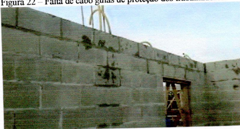
Figura 22 – Falta de cabo guias de proteção dos trabalhadores.
