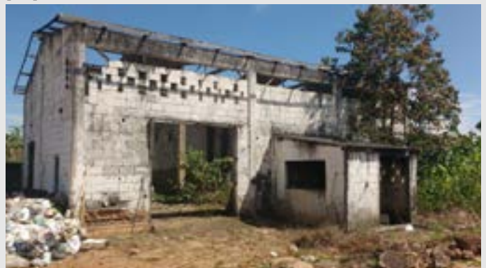
[63] Vista do anexo deteriorado.
