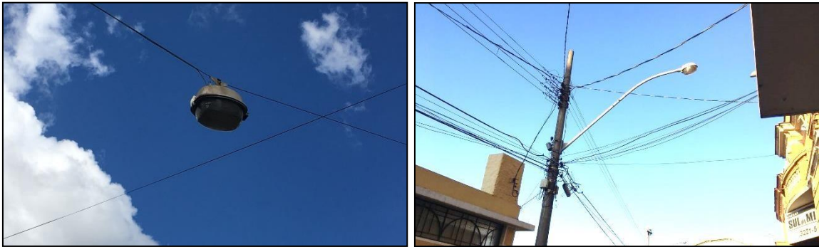
Figura 85 - Iluminação direta suspensa e convencional em postes
