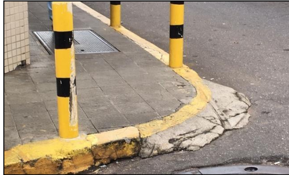
Figura 88 - Rampa de acessibilidade fora da norma de acessibilidade
