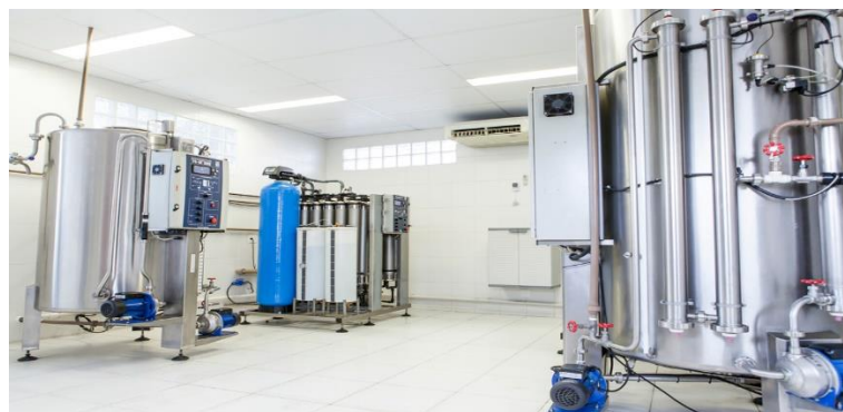
Figura 15: Sala de Tratamento de Água.
