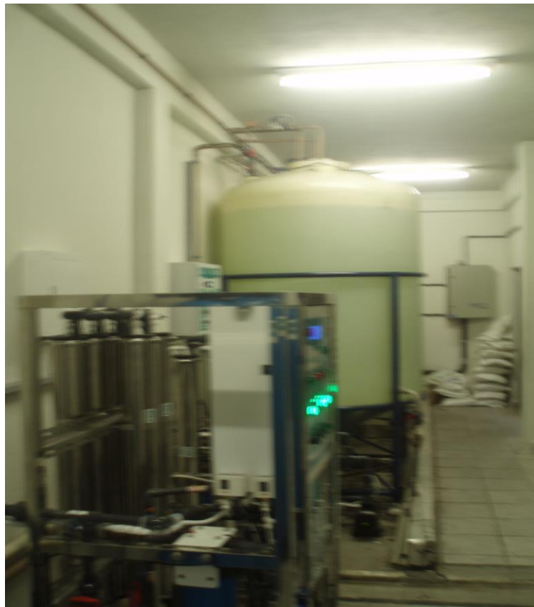
Tratamento de Água
