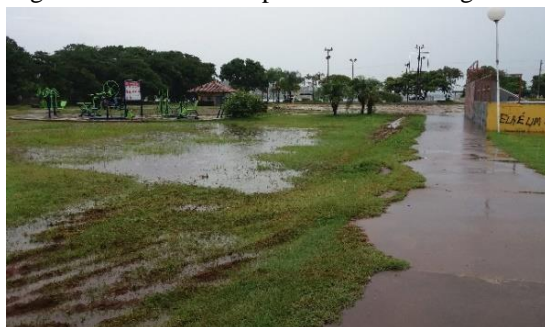
Figura 114 – Área com problema de drenagem.
