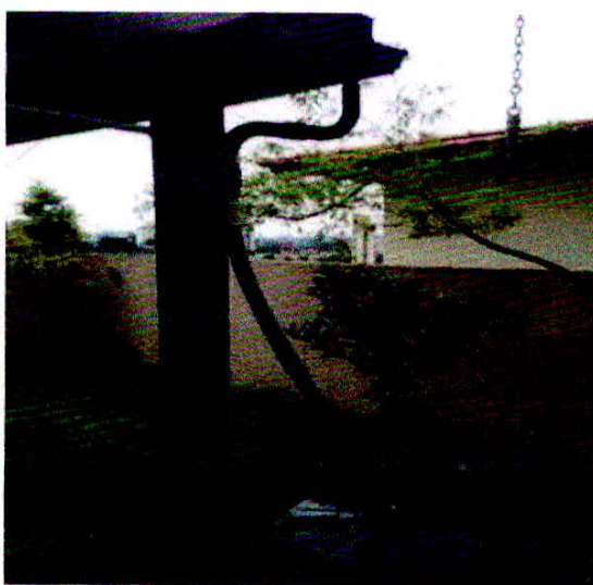
Figura 10: Sistema de captação da água da chuva. Fonte: Arquivo pessoal (2015).
