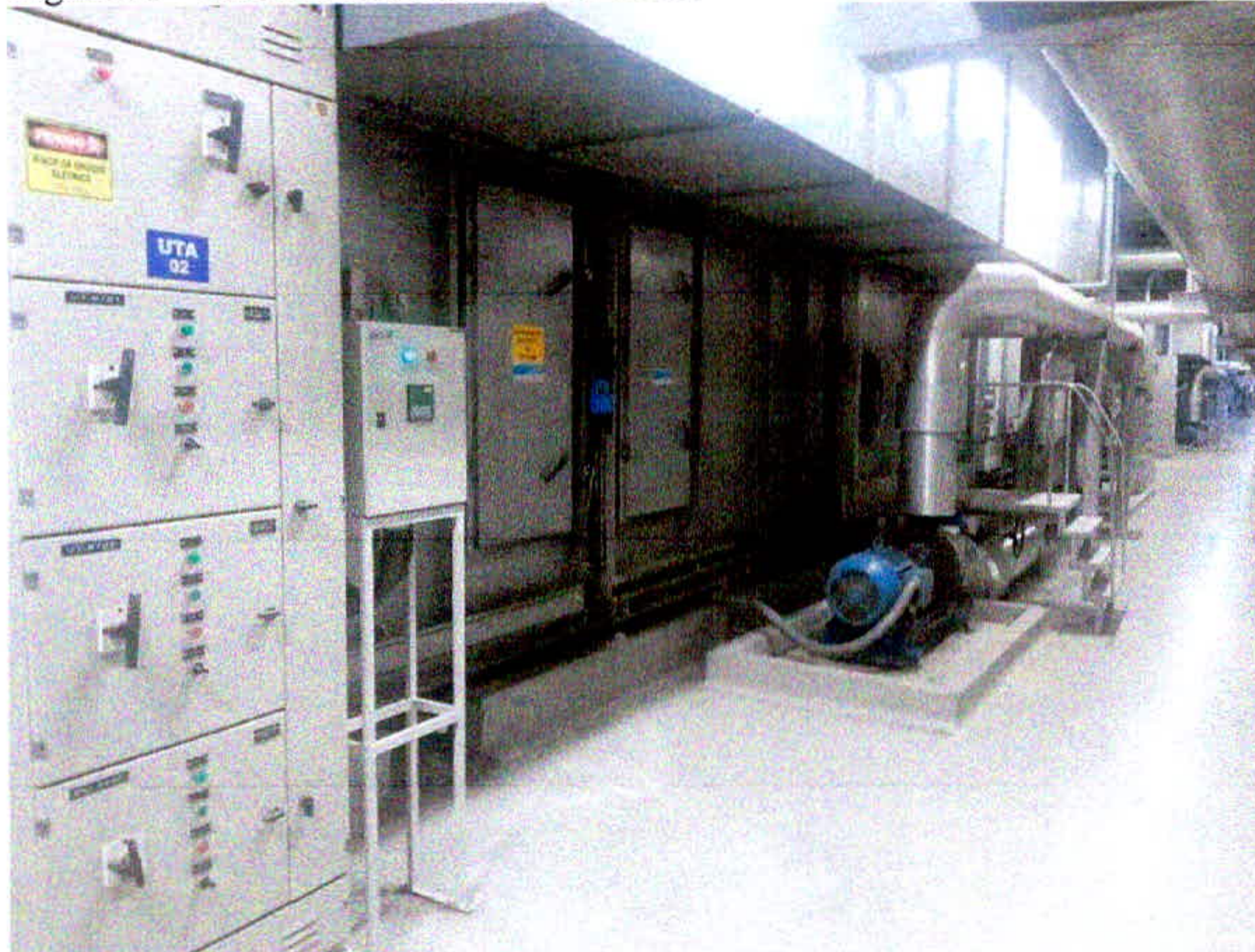
Figura 10 – Unidade de tratamento de Ar 02
