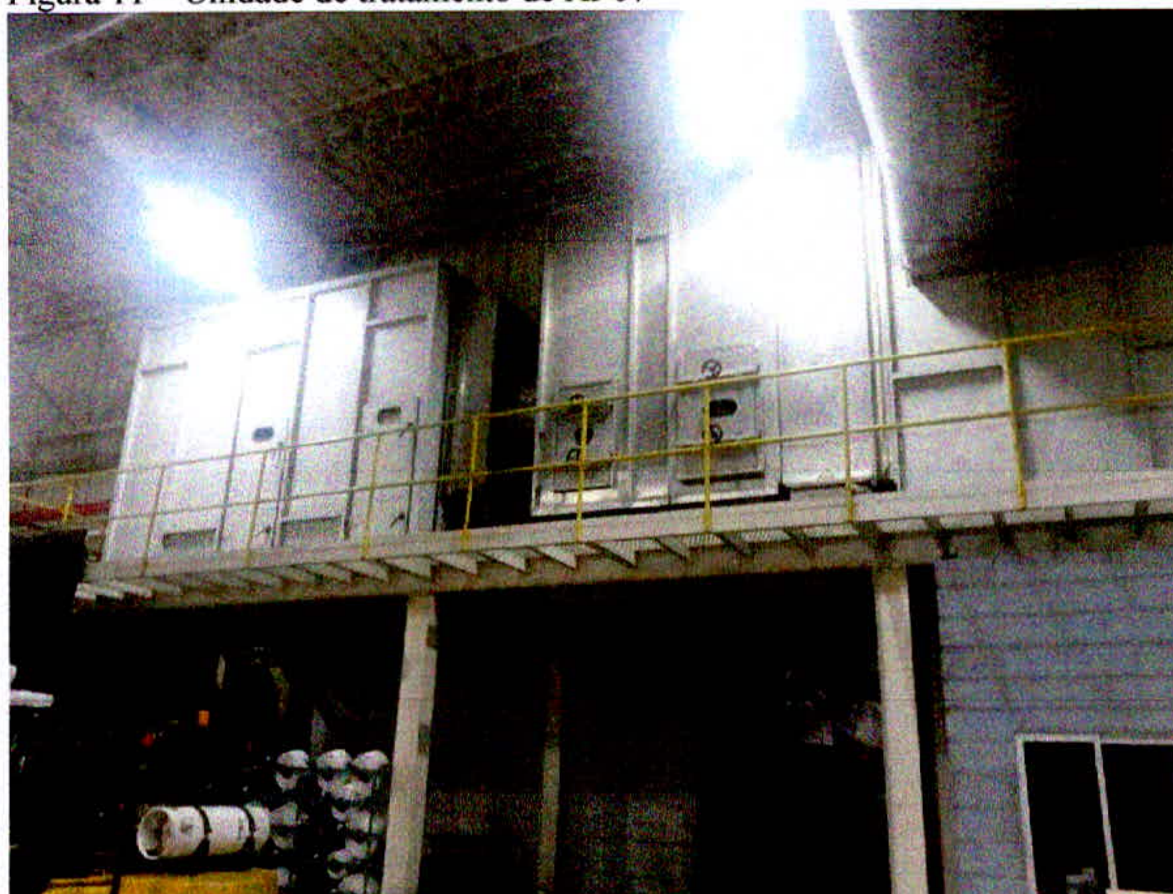
Figura 11 – Unidade de tratamento de Ar 07
