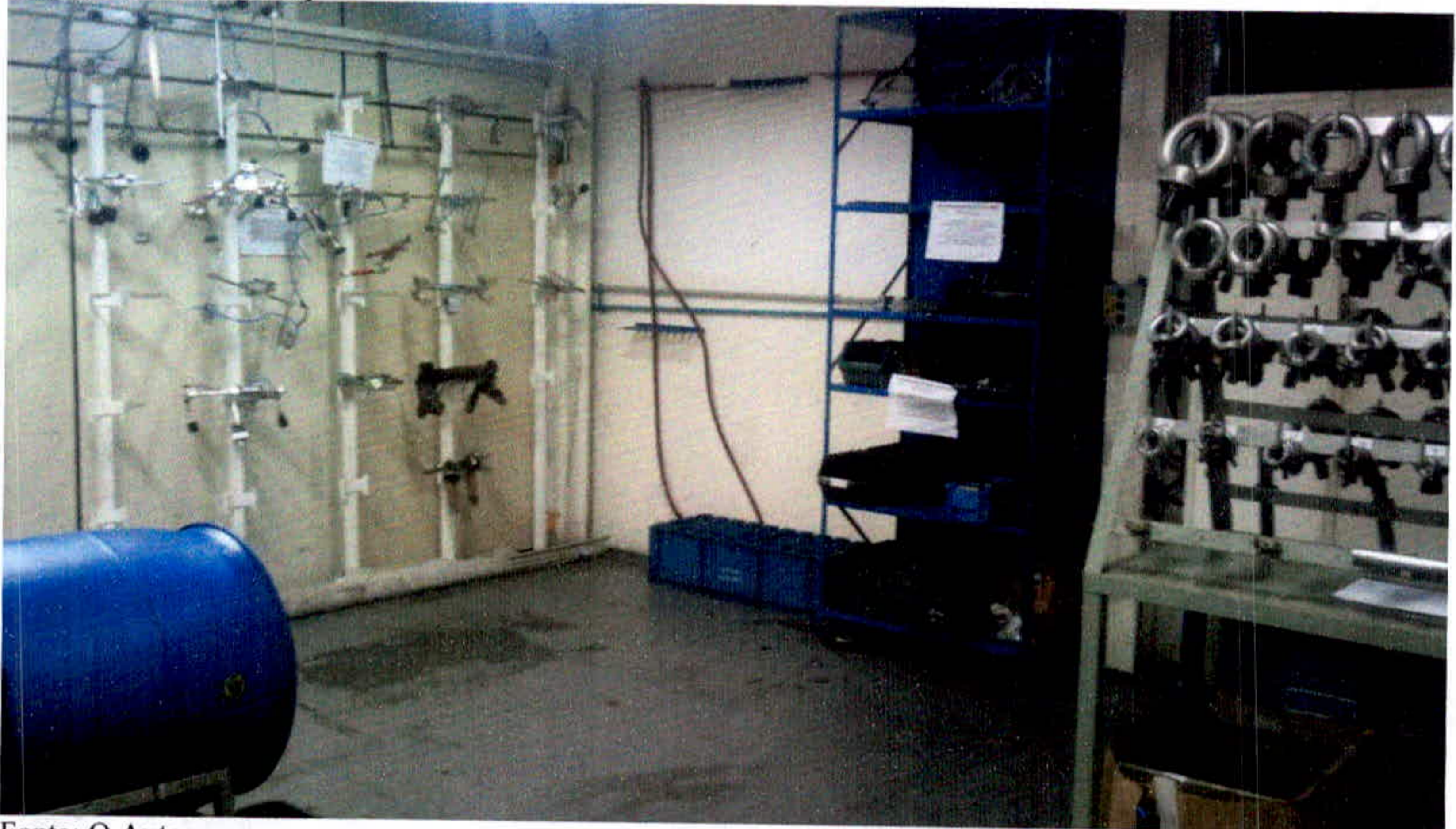
Figura 14: Sala de Setup
