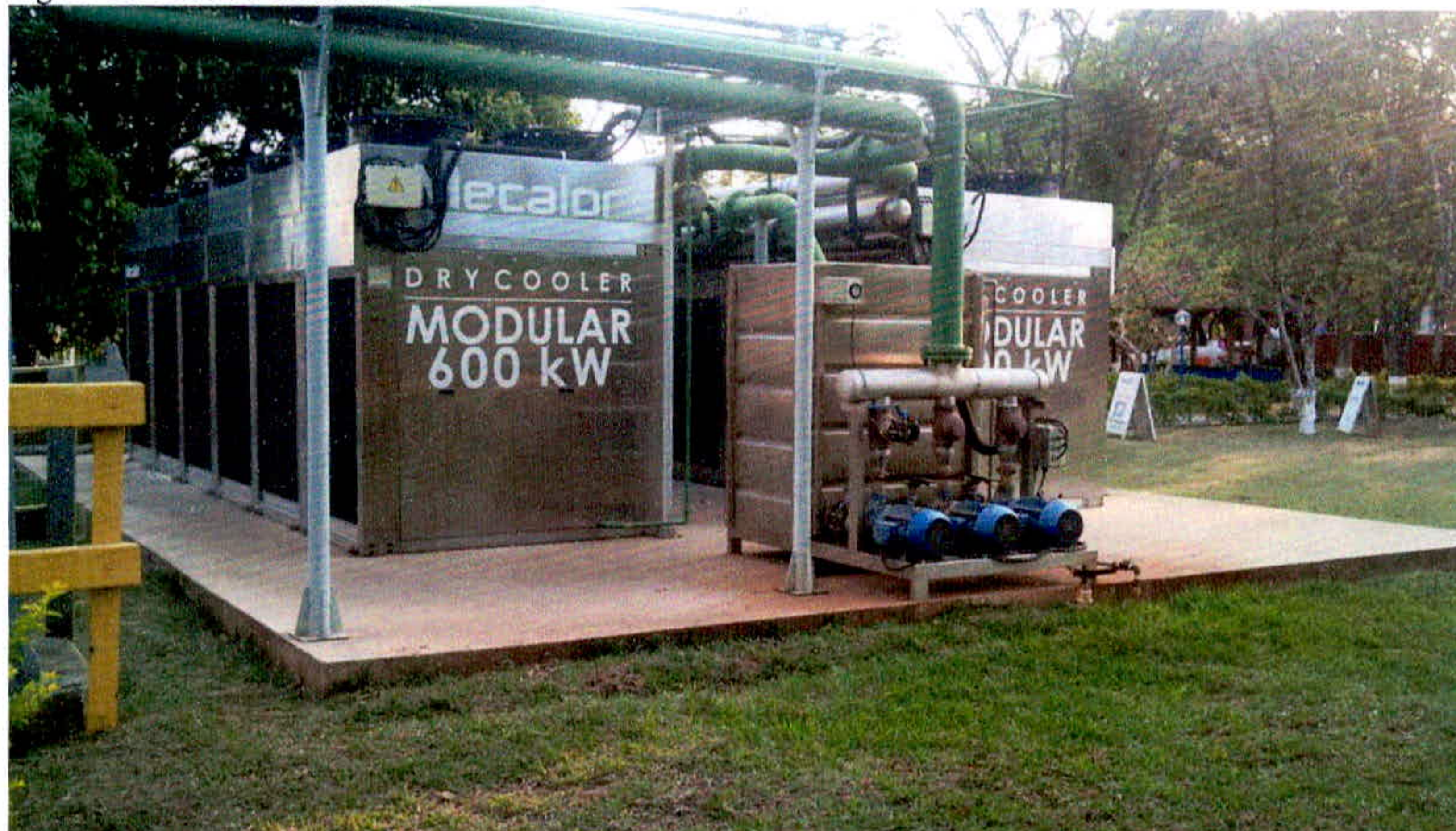
Figura 06: Torre de resfriamento
