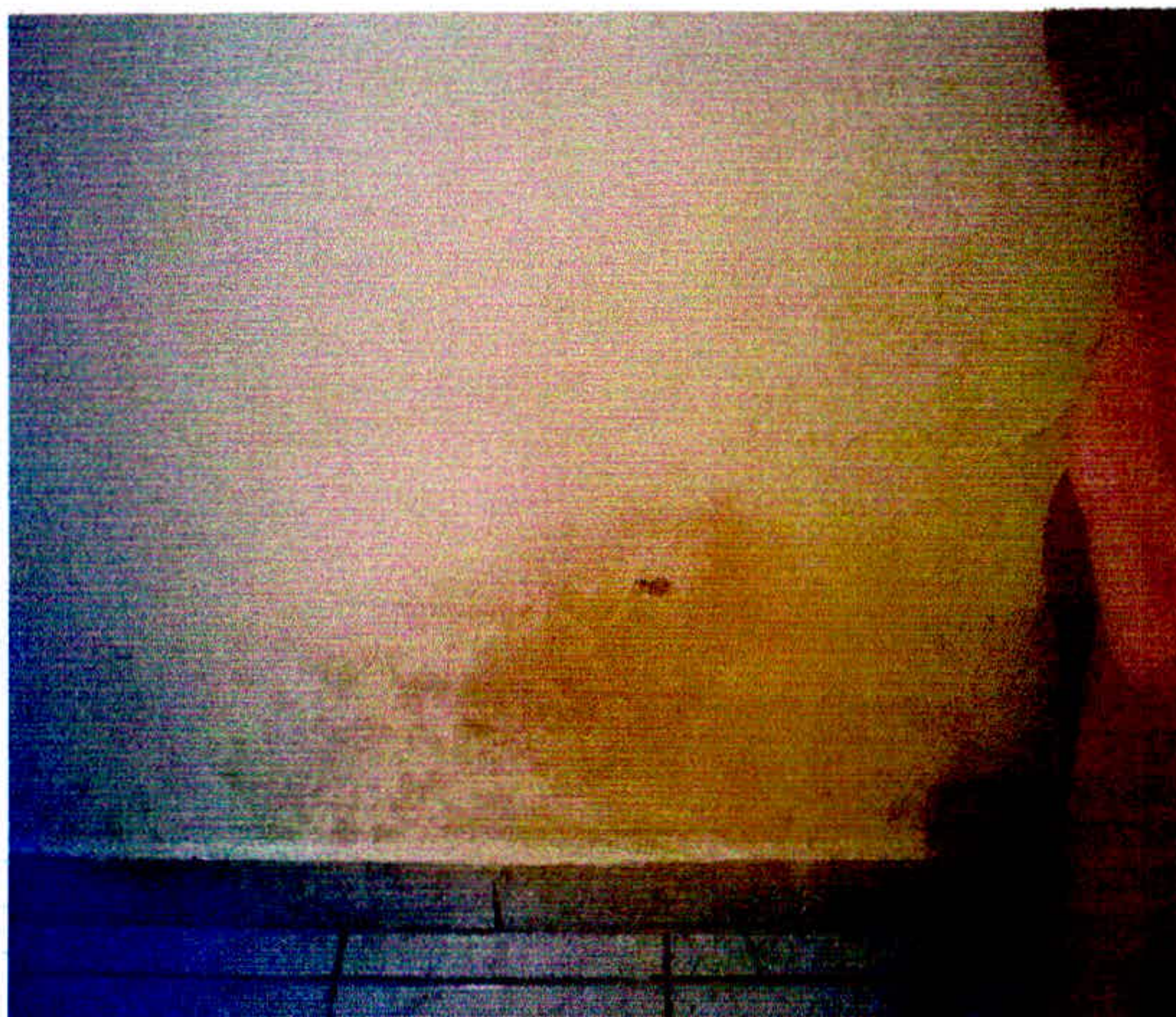
Figura 12 – Parede 09 - Umidade Acidental
