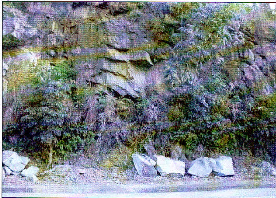
Figura 8 - Talude rochoso, com quedas de blocos.
