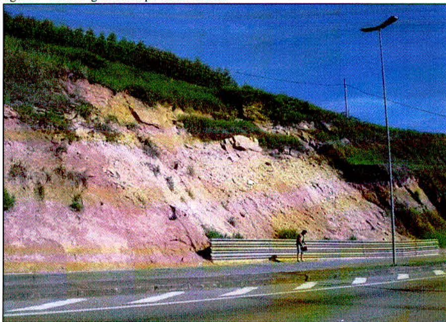
Figura 7 - Escorregamento tipo translacional.
