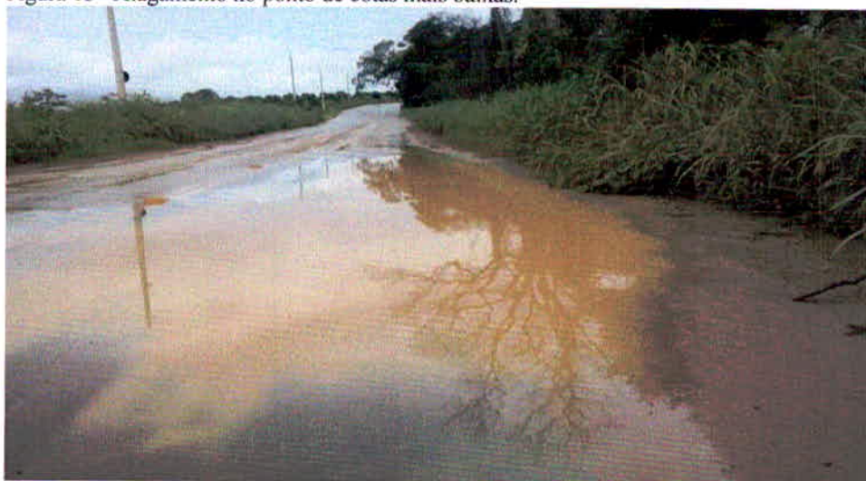
Figura 13– Alagamento no ponto de cotas mais baixas.
