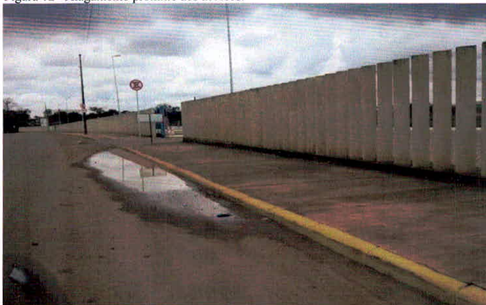
Figura 12– Alagamento próximo aos acessos.
