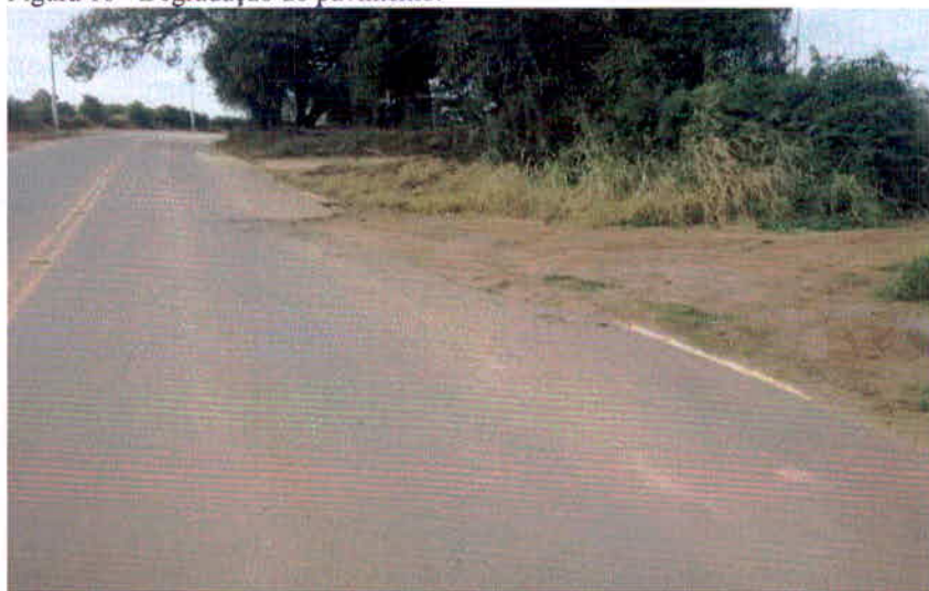
Figura 10– Degradação do pavimento.
